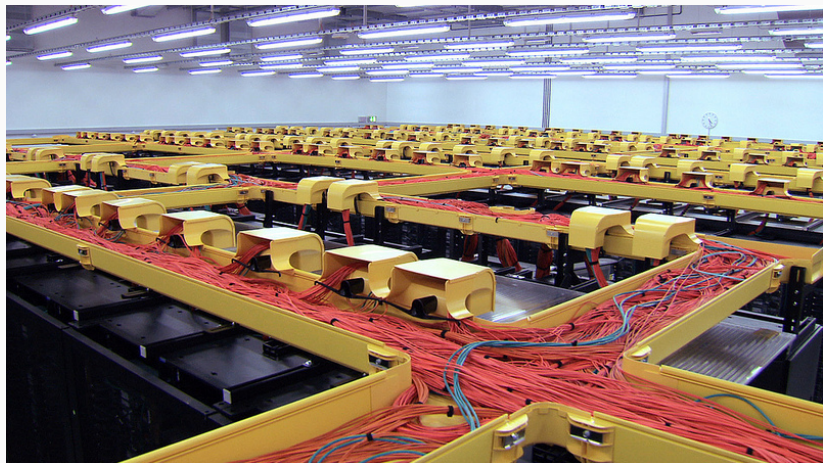
Refroidissement liquide du SuperMUC
